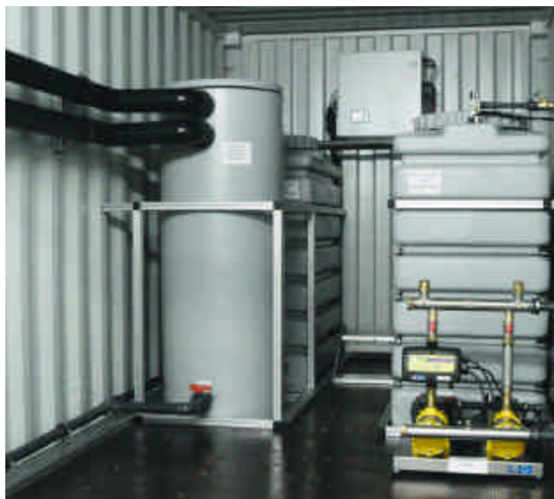
Eigenes Hauswasserwerk zur Aufbereitung von Niederschlags- und Grauwasser in Badewasserqualität
